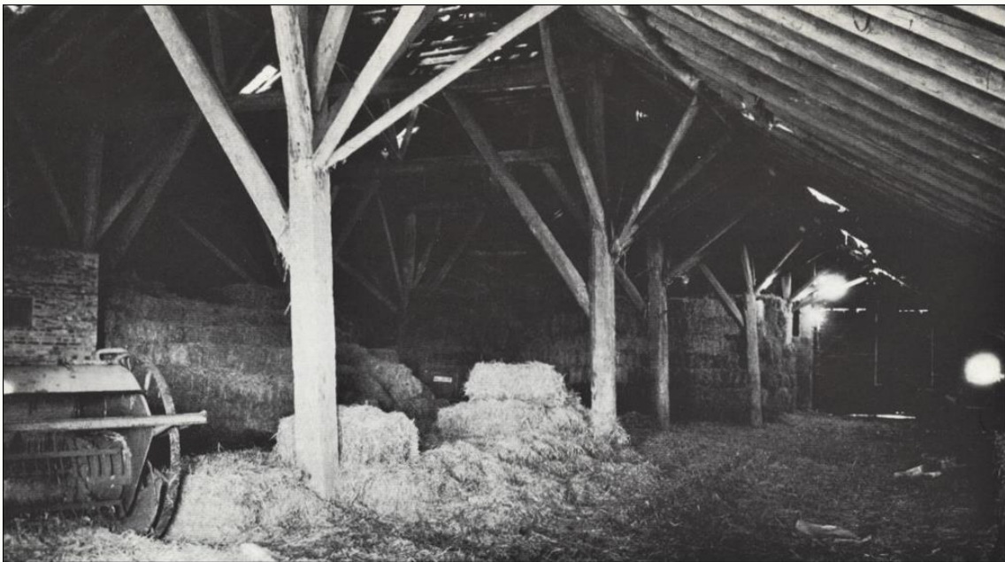
2. Bedrijfsgedeelte gezien naar de achtergevel. Links grondtas, rechts langsdeel met doorrit. Derde staande naar achteren gesteld i.v.m. werkruimte dorsrol.
